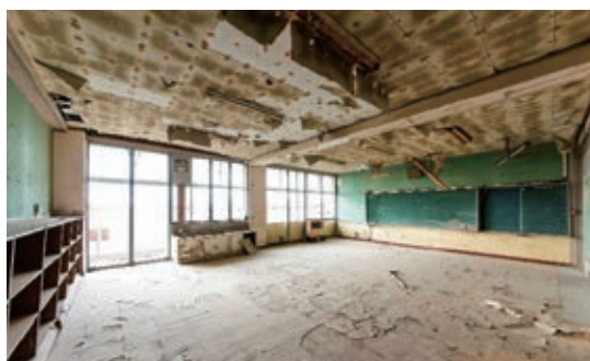
震災遺構 仙台市立荒浜小学校
