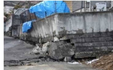
▲内陸部の擁壁被害(青葉区折立)
