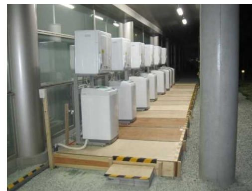
新たに設置された洗濯機と乾燥機 (2011.4.13宮城野体育館)
